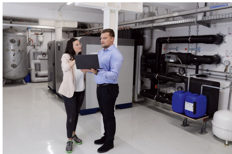
Überprüfung der Betriebsdaten vor Ort
