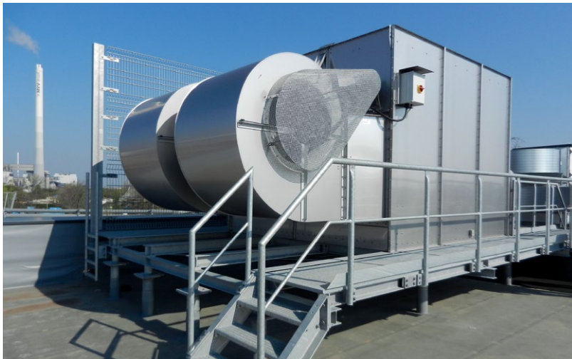
Neues Prüffeld - Kühlturm
