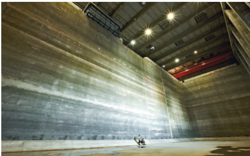
Die Lagerbunker des HKW können Brennstoff für mehrere Tage Betrieb aufnehmen.
